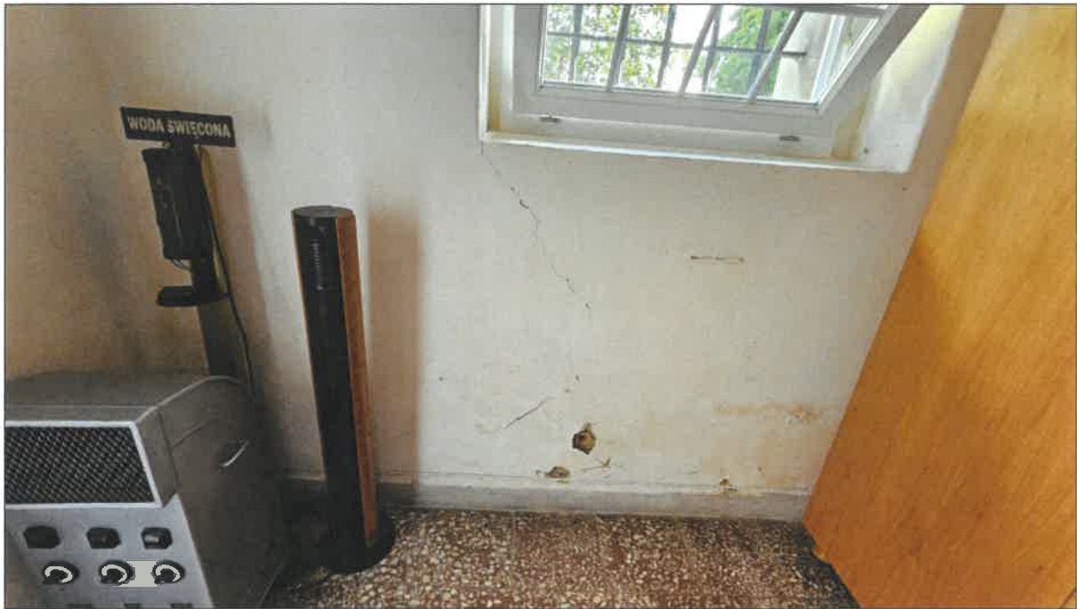
Fot. 12. Wnętrze zakrystii – ściana południowa spękana i zawilgocona.
