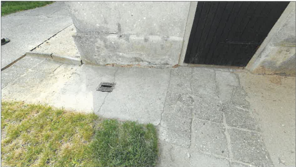
Fot. 11. Nierówności nawierzchni przy wejściu do zakrystii w ścianie wschodniej.
