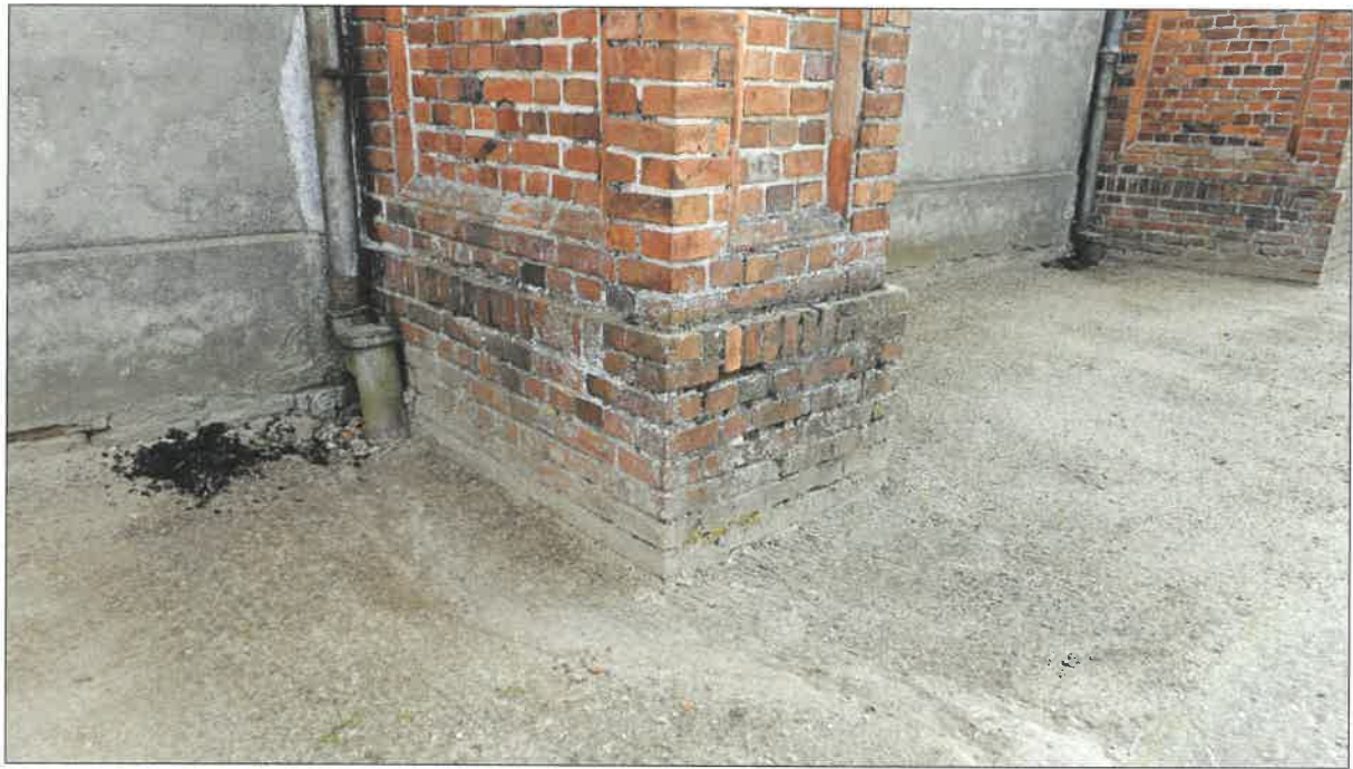
Fot. 27. Piaszczysta nawierzchnia wzdłuż ściany północnej nawy.
