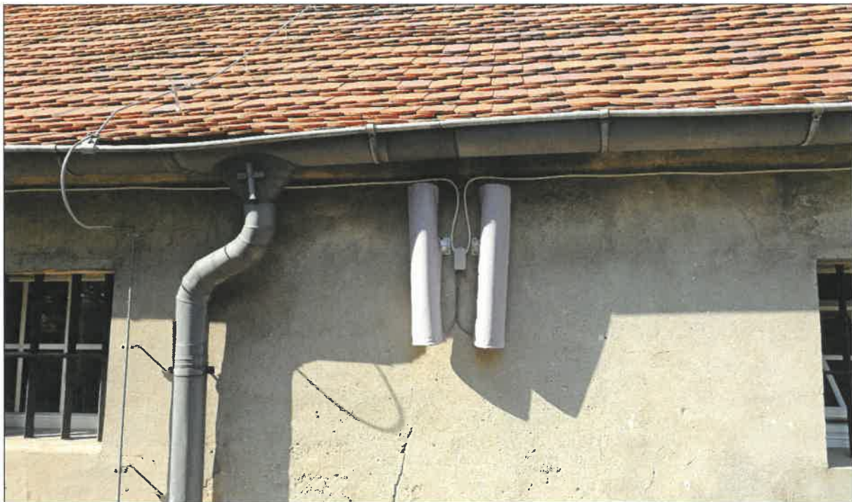
Fot. 9. Instalacja nagłośnienia w elewacji południowej zakrystii.
