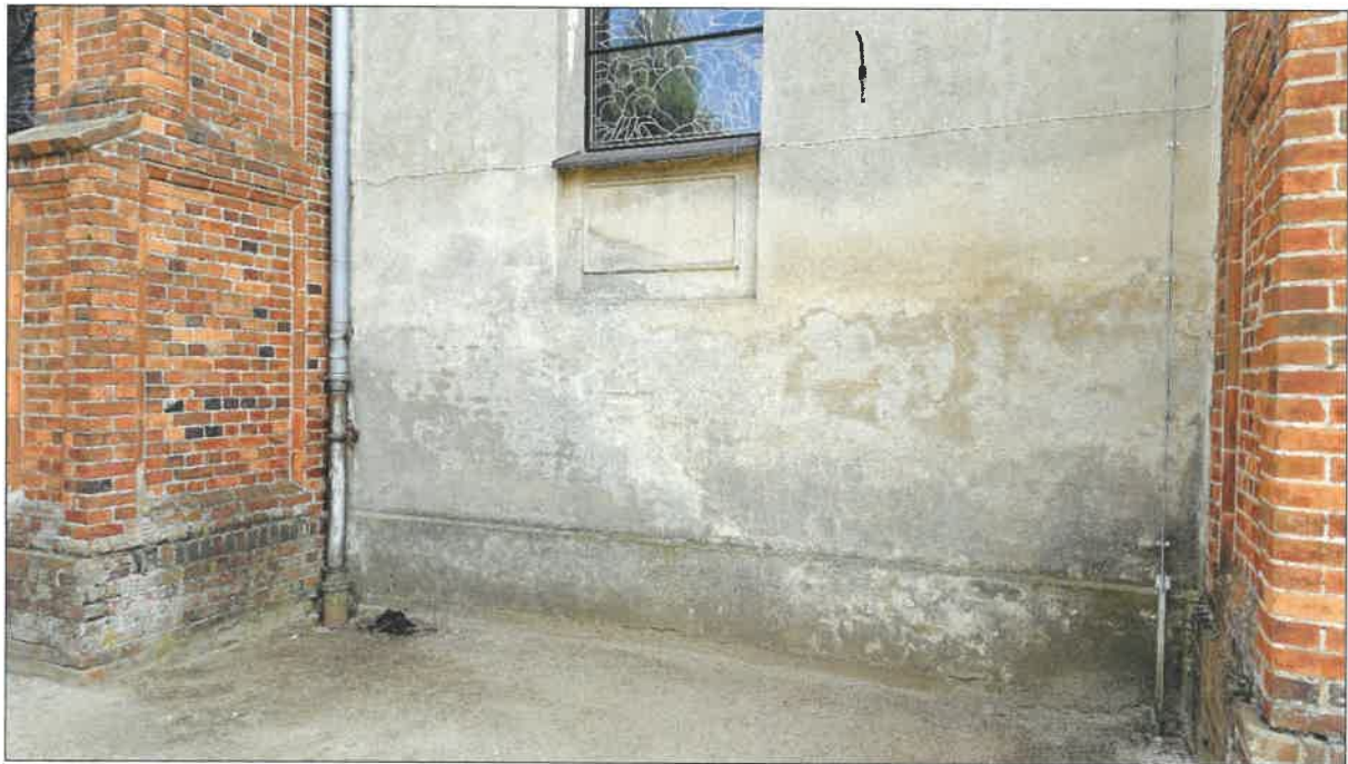
Fot. 28. Fragment elewacji północnej nawy – widoczne działanie wilgoci w dolnych partiach ściany. Uszkodzenia tynku, przebarwienia i kolonie mikroorganizmów.
